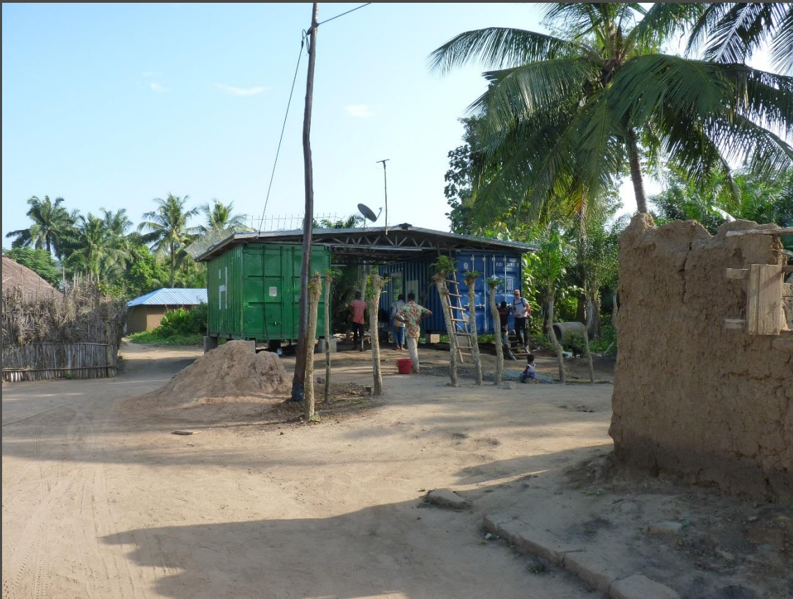
Figure 3 – Les 2 containers accueillent les installations électriques, le champ solaire ainsi que la plateforme multi-services destinée aux habitants.
